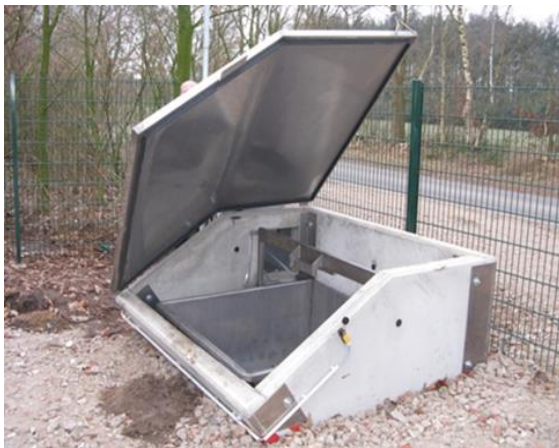
Abbildung 29: Erdkühlung mit externem Kühlaggregat; Deckel mit Seilwinde zum Öffnen; Abholung ohne Befahren des Betriebes ©LMG Nord
